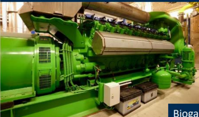
Biogas engines 3 x 1,4 MW
